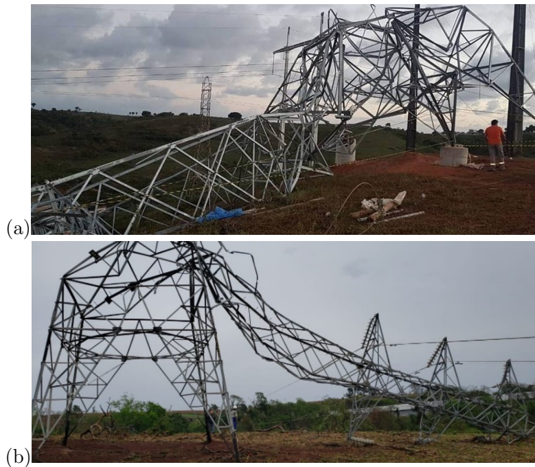
Figura 1.1: Registros de quedas de torres de linhas de transmissão: (a) na Bahia, no ano de 2016, e (b) no Paraná, em 2021 [Fontes: TV Bahia (a) e COPEL (b)]
