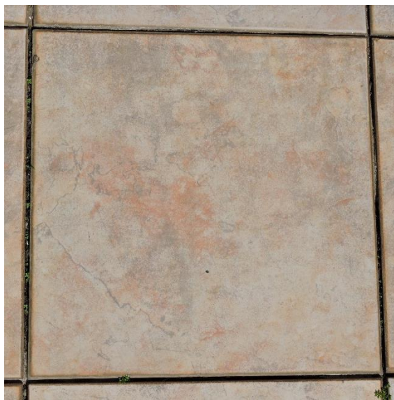
Figura 7 - Deterioração das juntas
