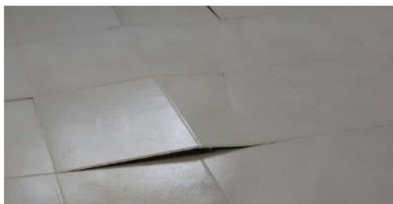
Figura 3 - Descolamento Cerâmico (Santos, 2019)
