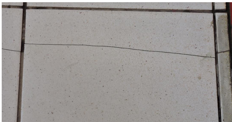
Figura 5 - Fissuras e trincas
