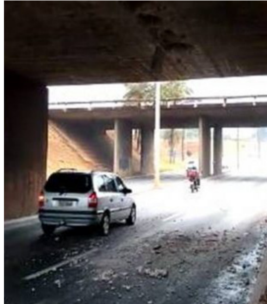
Figura 1-4 - Queda de placas em viaduto próximo a Ponte Costa e Silva
