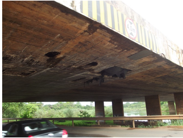
Figura 1-3 - Danos na Ponte do Bragueto
