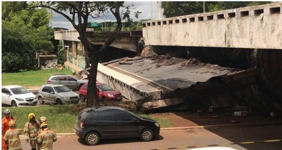
Figura 1-2 - Viaduto do Eixo Rodoviário após o desabamento
