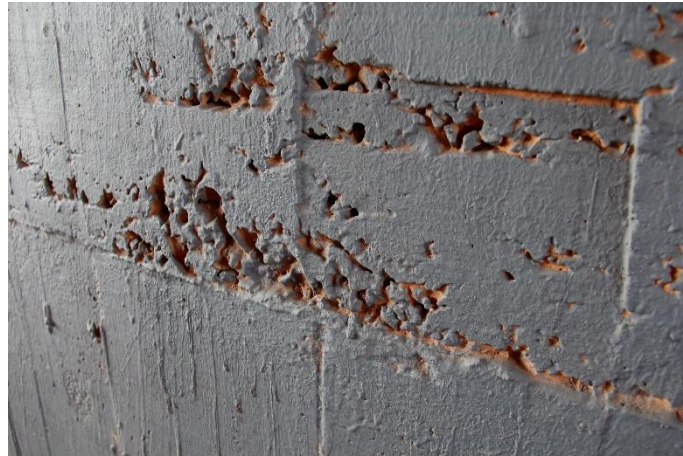
Figura 2-2 Exemplo de falha de concretagem - Viaduto sob o Eixo Monumental próxima à catedral militar 1
