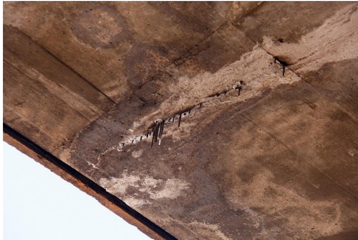
Figura 2-5 Exemplo de eflorescência - Viaduto 1 acesso ao Guará/EPNB.
