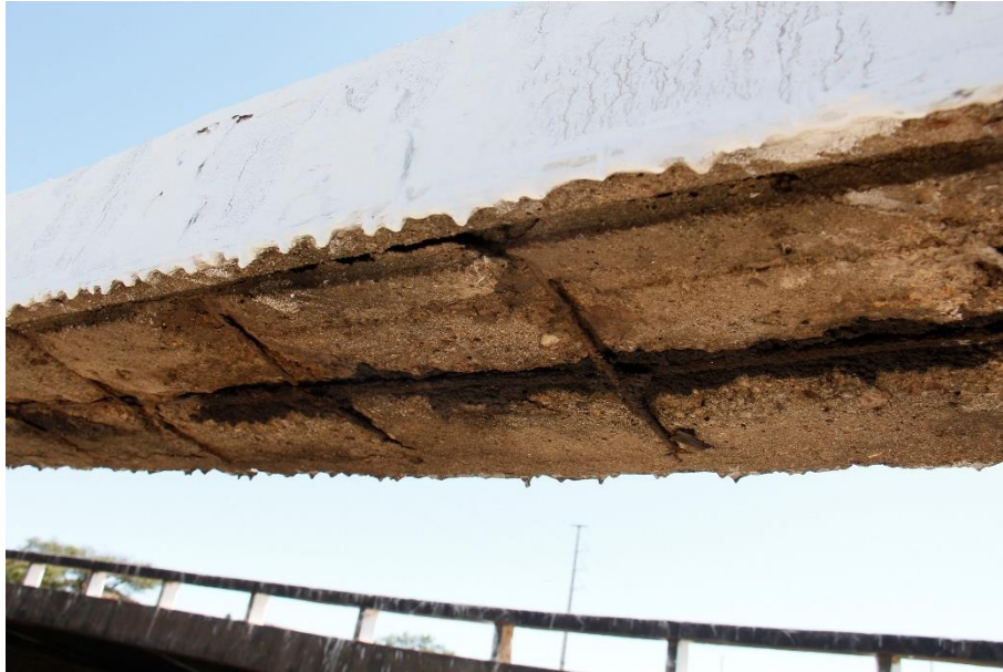
Figura 4-20 Guarda-rodas Oeste com exposição de armaduras Viaduto 1 acesso Guar – Sent. Zoolgico
