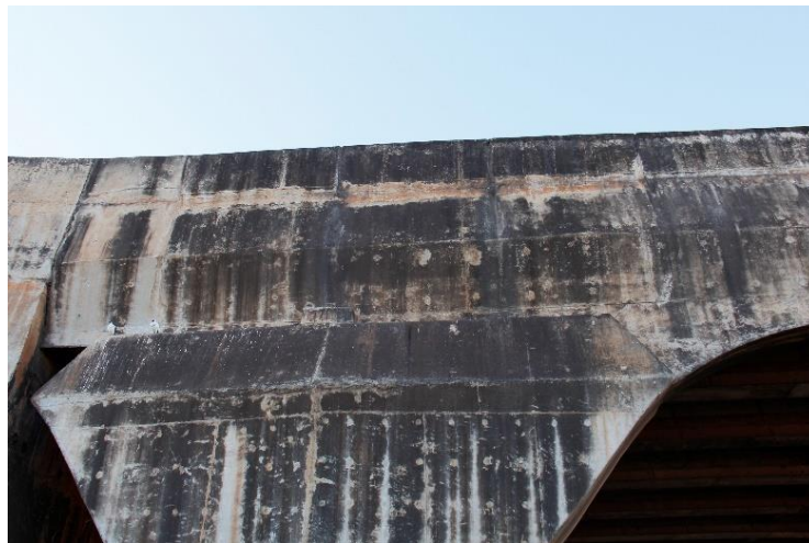
Figura 2-1 Exemplo de manchas na superfície do concreto – Viaduto sobre DF-003 Eixo Monumental/Taguatinga
