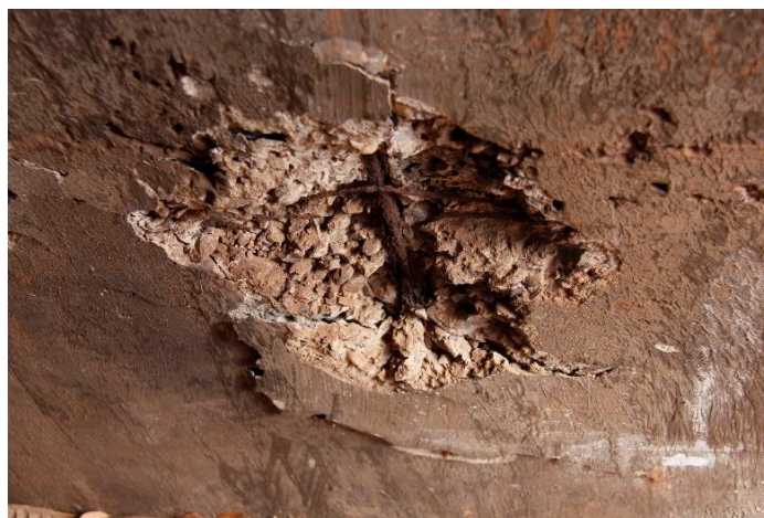
Figura 2-8 Exemplo de deslocamento do concreto - Viaduto sob o Eixo Monumental próximo à catedral militar
