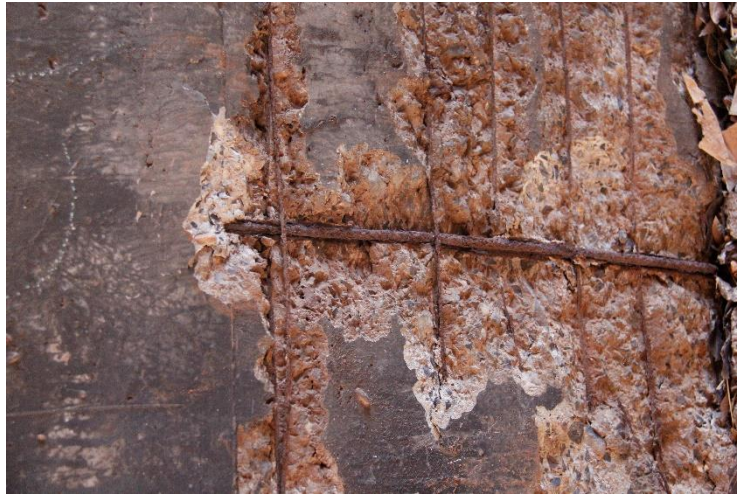
Figura 2-6 Processo de corrosão em pilar – Viaduto 1 entrada SMU/DF
