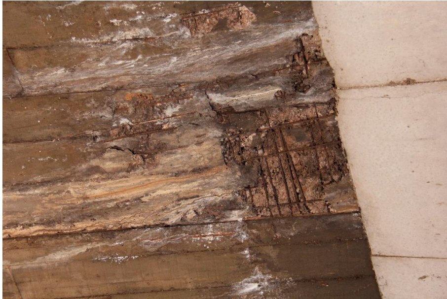
Figura 4-16 Detalhe exposição de armadura tabuleiro Norte 1 Viaduto 1 acesso Guar – Sent. Zoolgico
