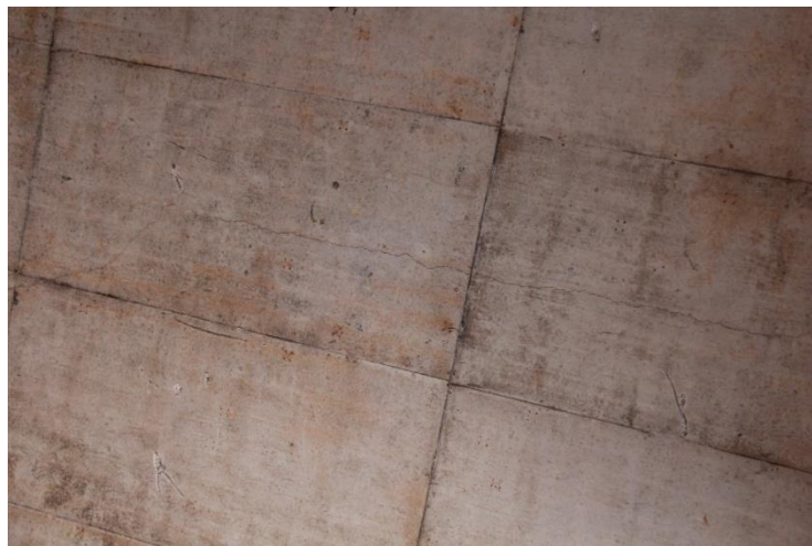
Figura 2-4 Exemplo de fissura - Viaduto 2 sobre a DF-085 entrada Guará.
