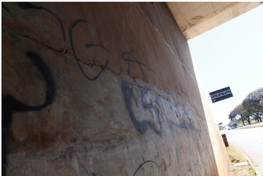
Figura 4-19 Cortina Sul com elevada fissurao Viaduto 1 acesso Guar - Sent. Zoolgico
