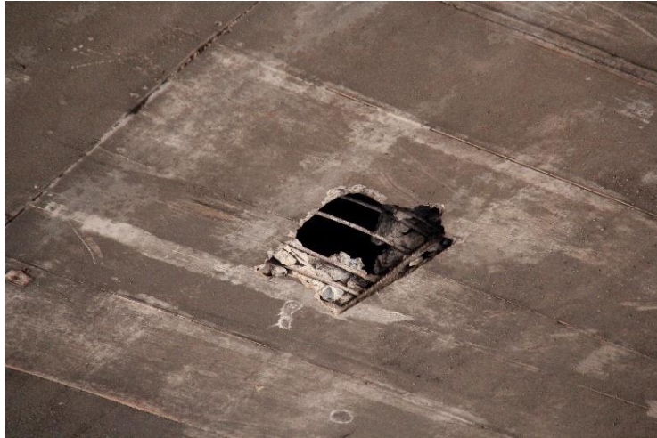
Figura 2-7 Exemplo de abrasão do concreto com exposição de armaduras - Viaduto SPMS sobre a DF-003
