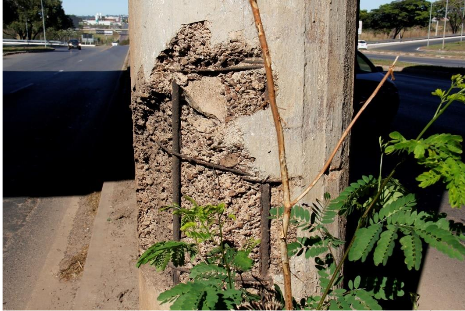
Figura 4-18 Pilar 5 com armadura exposta Viaduto 1 acesso Guar - Sent. Zoolgico
