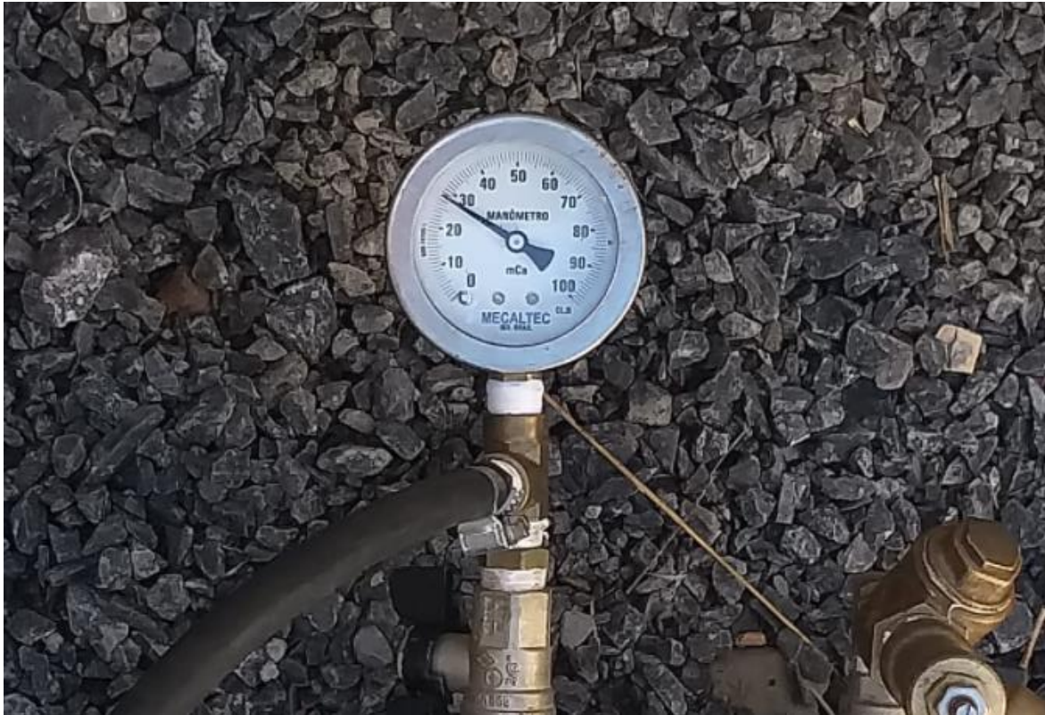
Figura 4.5 Manômetro instalado para aferir a pressão de jusante (mca)
