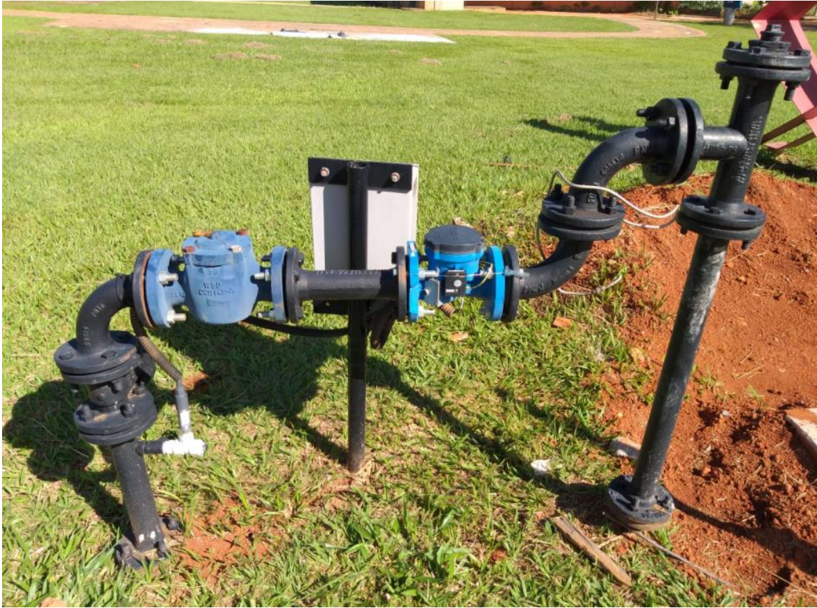
Figura 4.6 Cavalete com hidrômetro ultrassônico instalado no ICC
