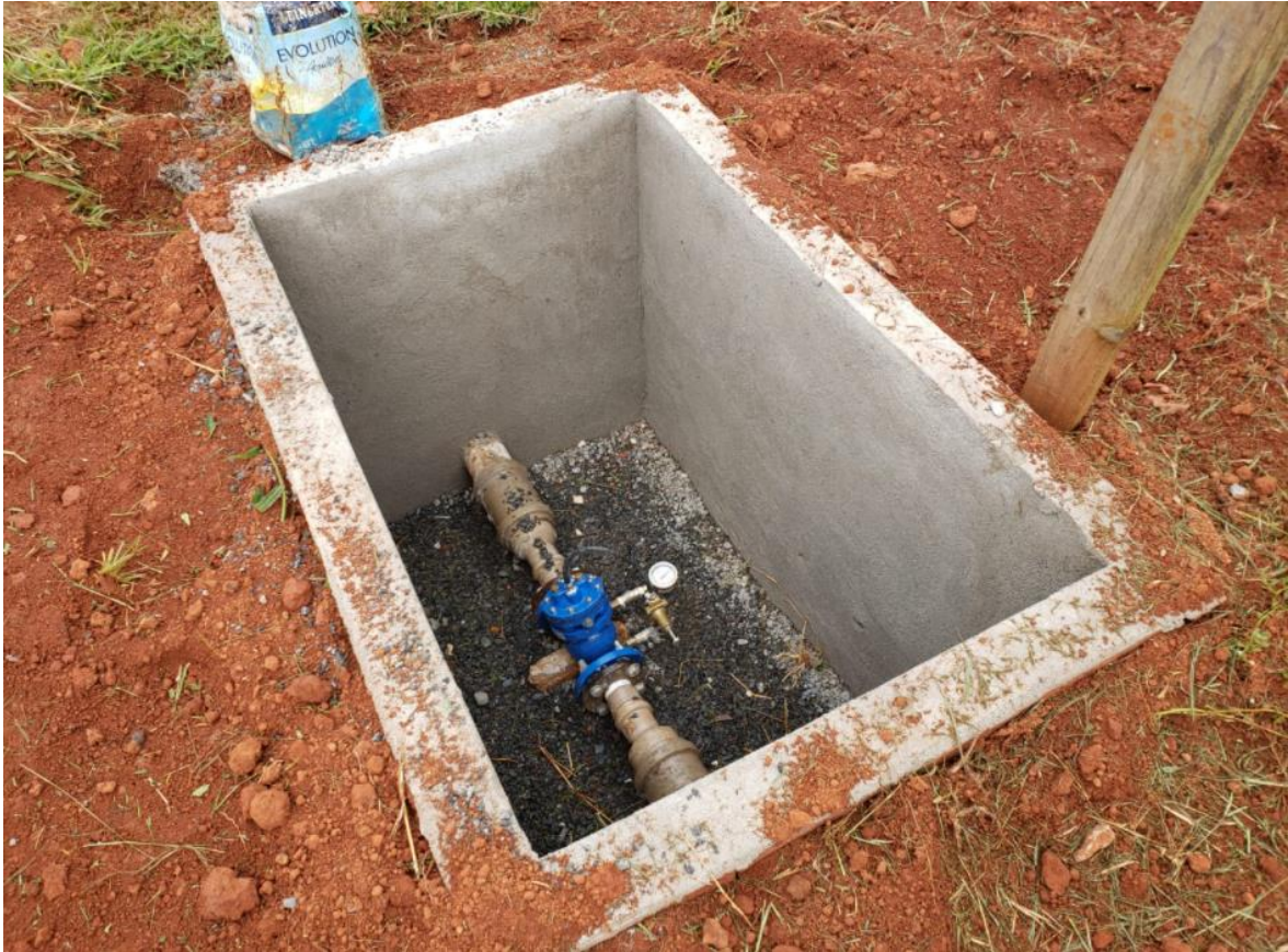
Figura 4.3 VRP instalada no ICC Sul
