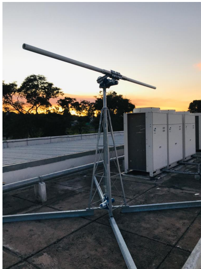
Figura 9 – Base e local onde será instalada a antena.
