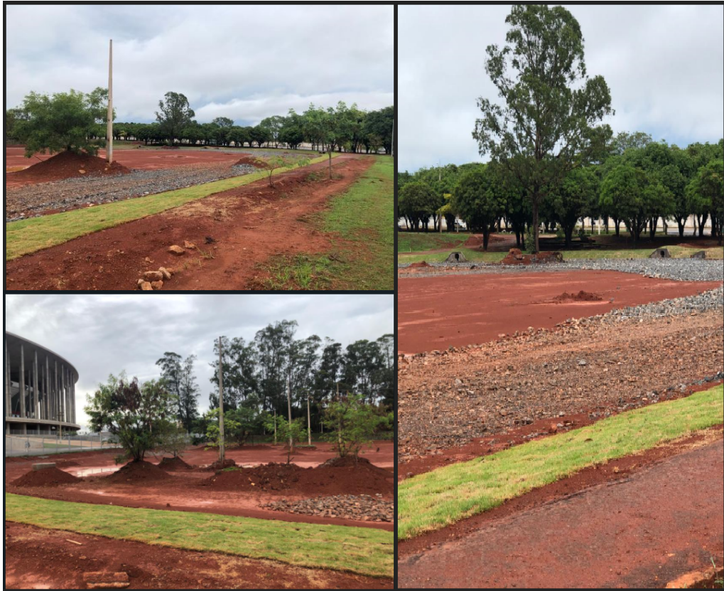
Figura 5.14 Fotos de uma das bacias de retenção utilizada no Cenário 2.
