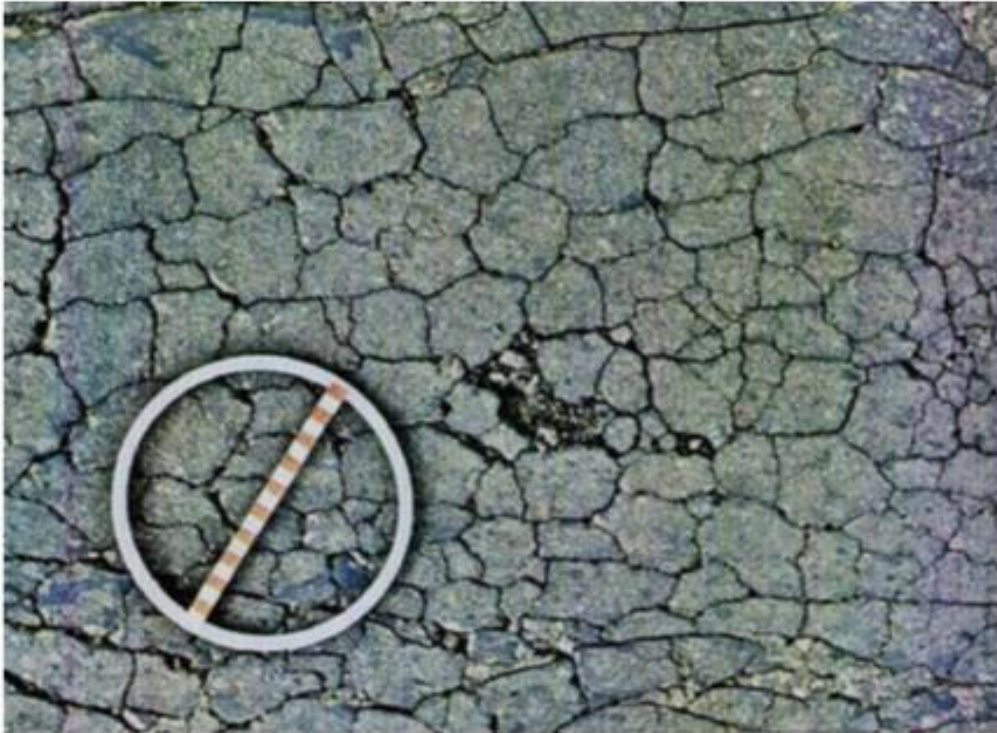
Figura 2.4: Trincas por fadiga (Fonte: DNIT 005/2003 - TER 2003)
