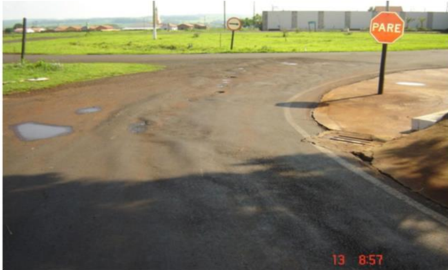
Figura 2.10: Corrugação em dispositivo de acesso à rodovia (Fonte: Arquivo DER/SP)
