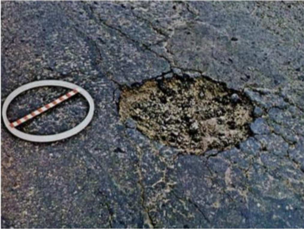
Figura 2.7: Buraco ou panela (Fonte: DNIT 005/2003 - TER 2003)
