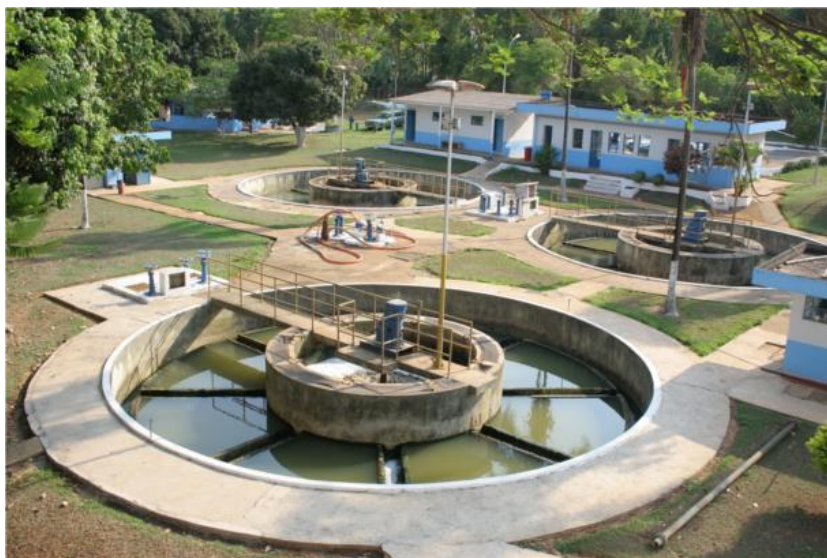
Figura 6 – Decantadores em Estação de Tratamento de Esgoto de Sobradinho.
