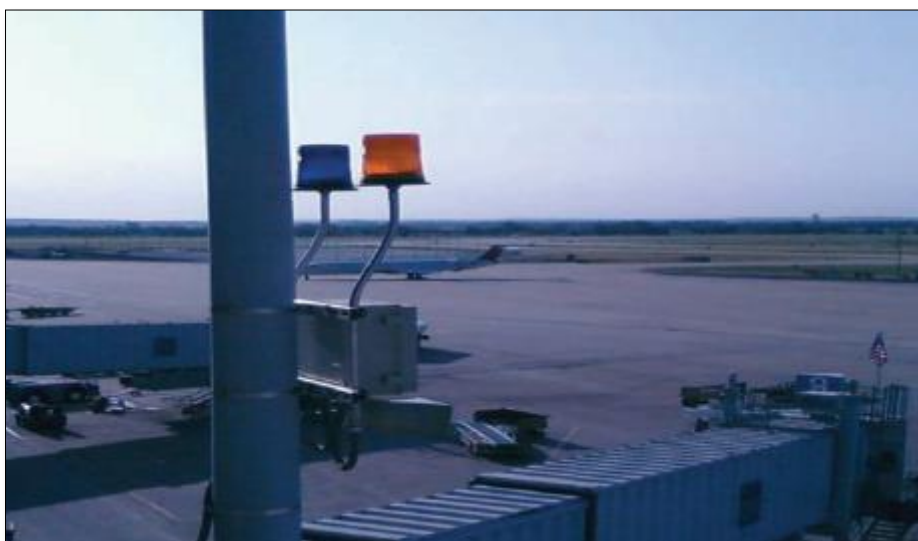
Figura 9.7 - Sistema de Alerta de Descargas Atmosféricas [46]
