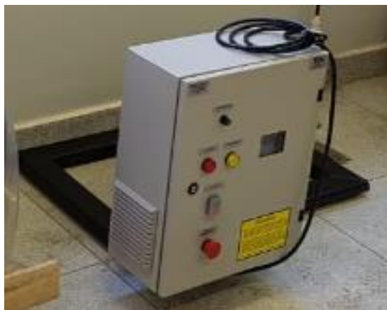
Figura 22: Suporte do comando elétrico e da bomba.
