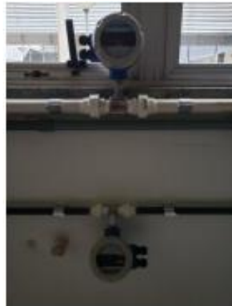
Figura 24: Medidores de vazão de ar e água.
