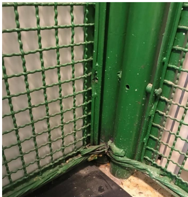
Figura 5.5- Ponto de conexão da malha de aterramento.
