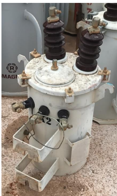
Figura 5.1- Transformador cedido pela CEB e utilizado no ensaio citado.
