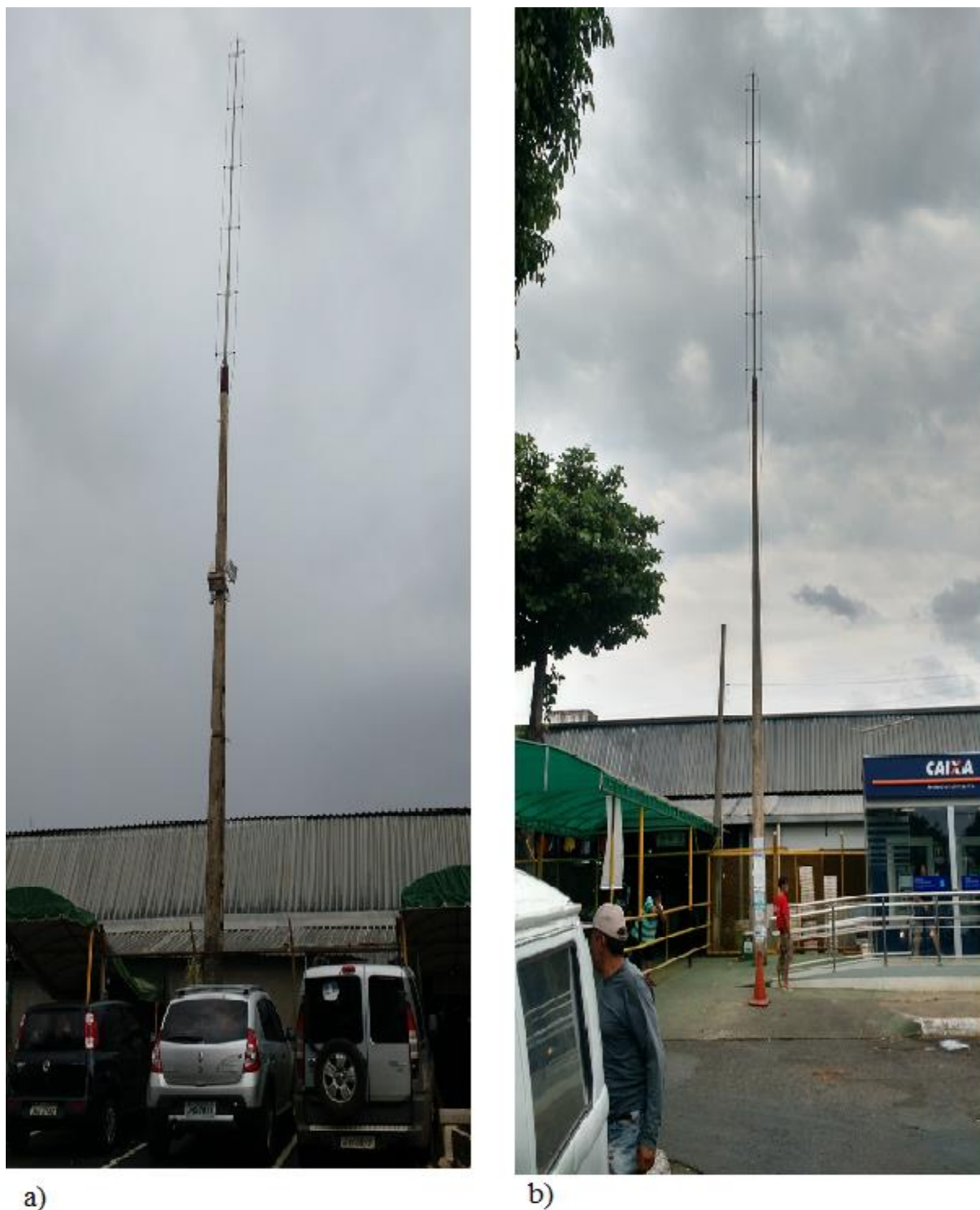
Figura 16 – a) Para-raios tipo Franklin situado do lado direito da Feira do Guar, prximo ao metro b) Para-raios tipo Franklin situado ao lado esquerdo da Feira do Guar.
