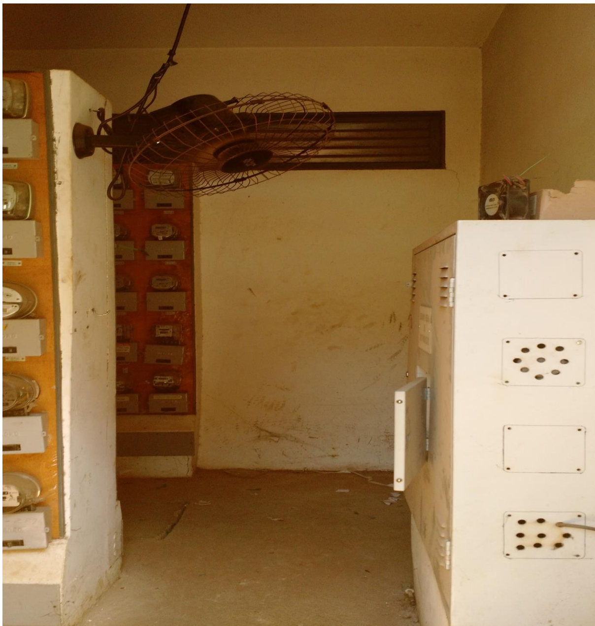
Figura 14 – Refrigeração do quadro geral
