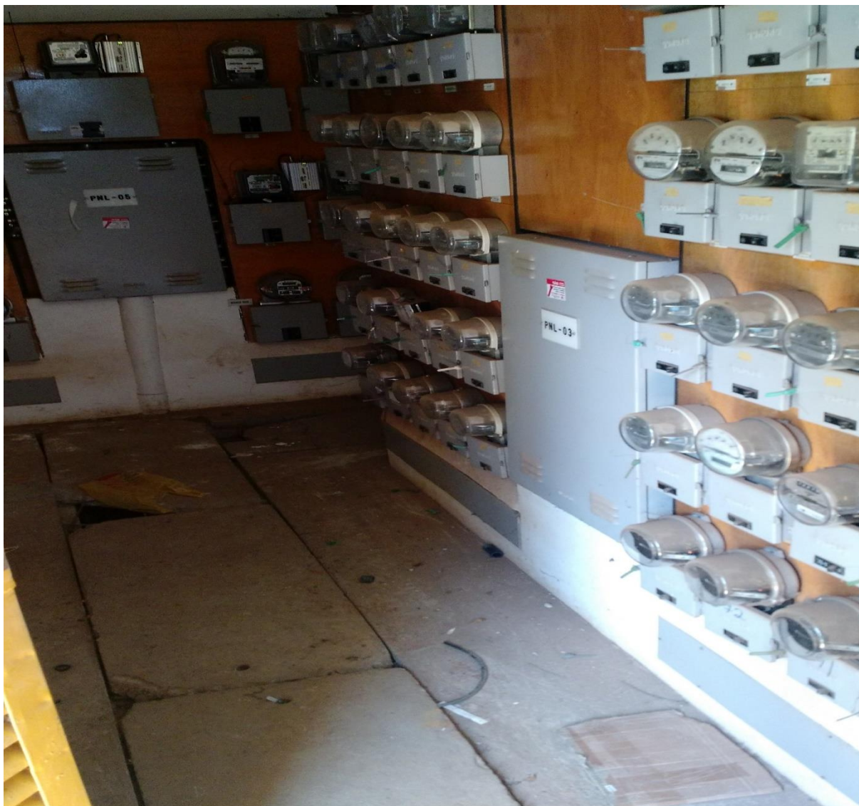
Figura 15 – Interior da casa de força
