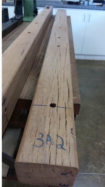
Figura 24. Rachaduras nas cruzetas. Fonte: Autor.
