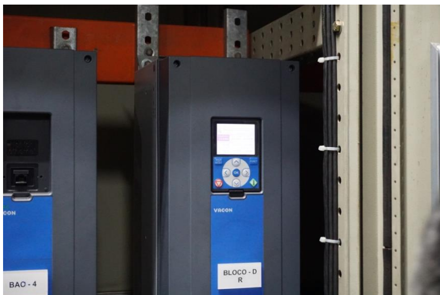
Figura 3.9 - Variador de frequência das bombas da CAG
