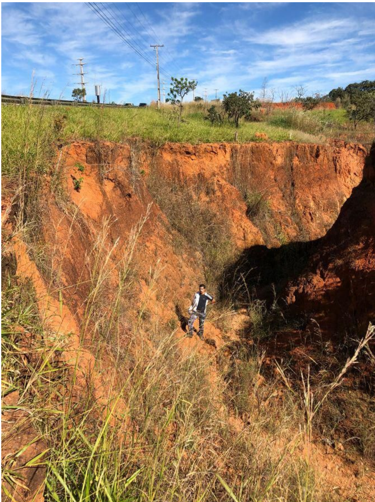
Figura 11 - Profundidade da Voçoroca
