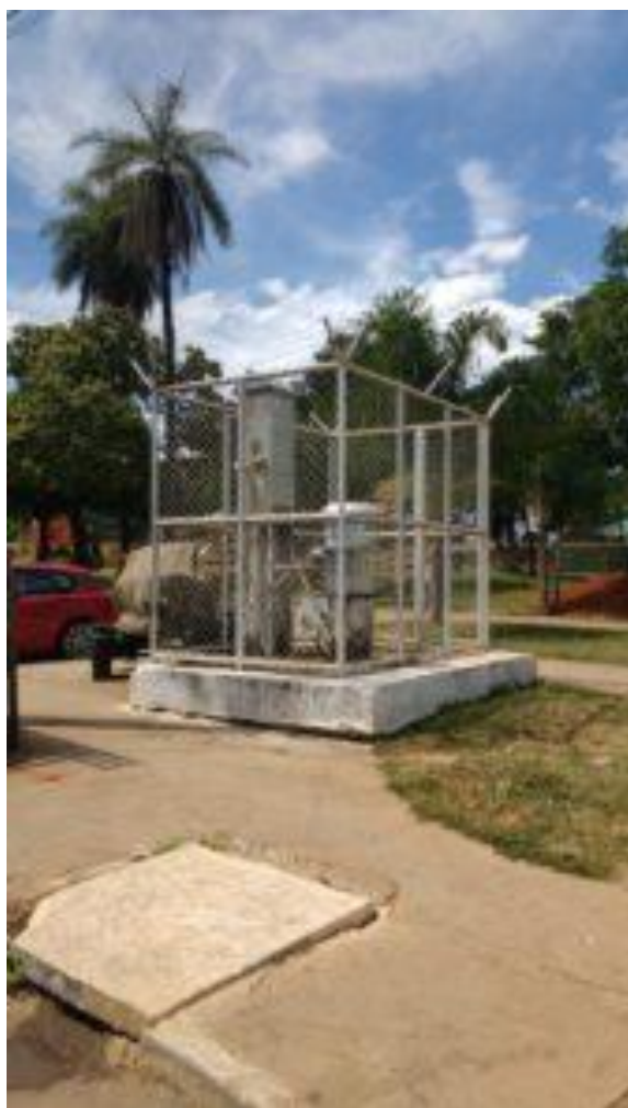
Figura 8 - Estação de monitoramento da qualidade do ar Fercal. Disponível em: http://www.ibram.df.gov.br/conheca-os-locais-de-monitoramento-da-qualidade-do-ar/ Acesso em jun. 2019.
