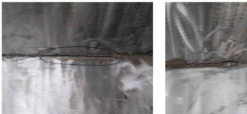
Figura 30 – Rompimento da Solda. Fonte: Comunicação Interna
