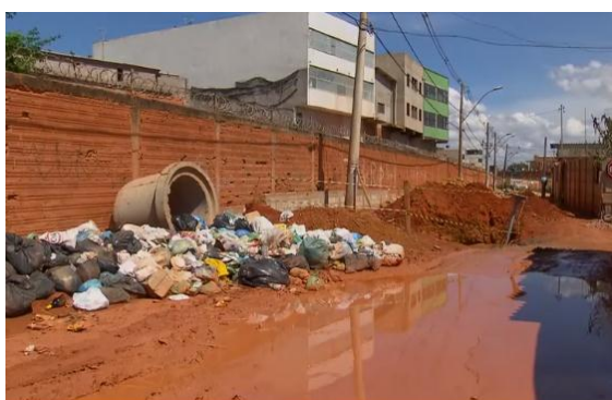
Figura 6. Avenida do setor Sol Nascente. Detalhe para a imensa quantidade de sedimentos e lixo. Fonte: G1, 2018.
