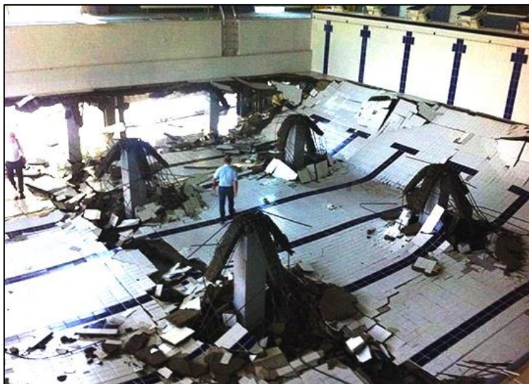
Figura 6 – Ruptura por punção de uma piscina na Rússia. [ https://www.engenhariacivil.com/ ]
