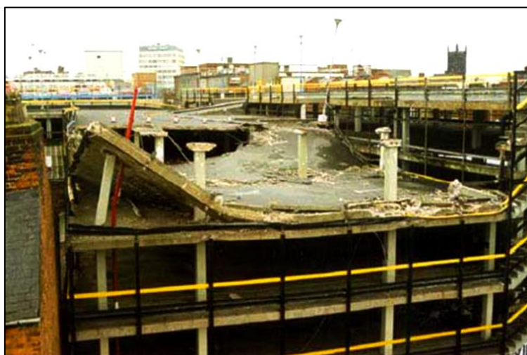
Figura 4 – Colapso parcial do edifício Pipers Row Car Park . [WOOD, 1997]
