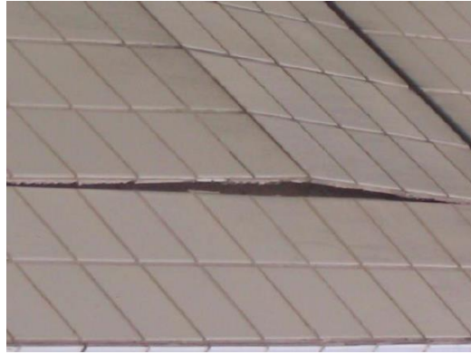
Figura 2.12 - Descolamento cerâmico (LEM – UnB, arquivo fotográfico apud Silva, 2014)
