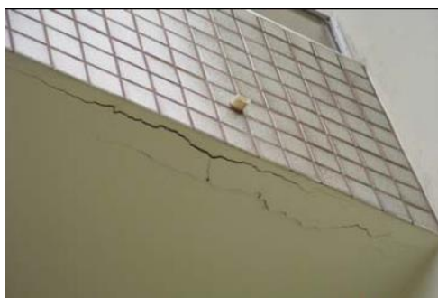
Figura 2.7 - Fissuras causadas pela corrosão da armadura da viga (SILVA, 2007)
