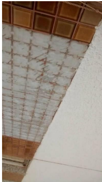
Figura 2.14 - Deslocamento na interface entre a placa cerâmica e a argamassa colante
