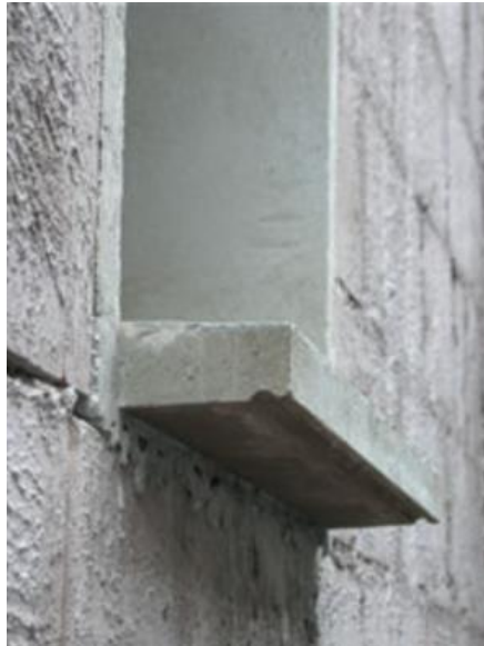
Figura 2.4 - Pingadeira sob o peitoril da janela (< http://www.techne.pini.com.br >)
