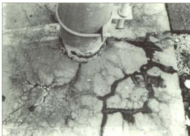
Figura 2.8 - Fissura provocada pela formação de etringita (Collepari M., 1999 apud Thomaz, 2003)
