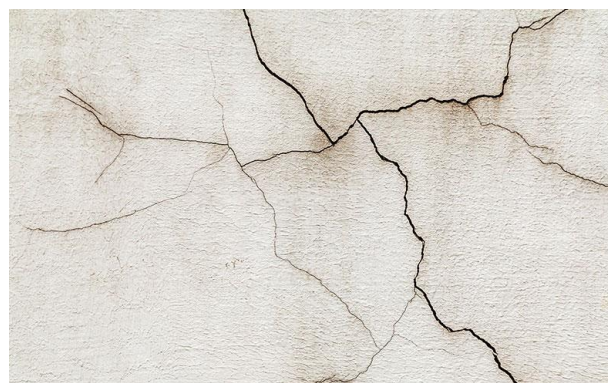
Figura 2.3 – Exemplo de fissuras mapeadas (< http://www.mapadaobra.com.br/ >)
