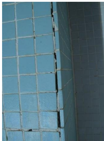
Figura 2.13 - Falha de rejunte (LEM – UnB, arquivo fotográfico apud Antunes, 2010)
