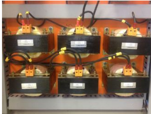
Figura 24 – Filtros Indutivos da Bancada Eólica (SILVEIRA, 2016)
