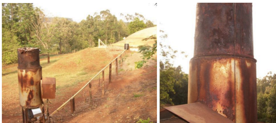
Figura 6: Queimador de Biogás após corrosão causada pelo H 2 S (HAAS, 2013).
