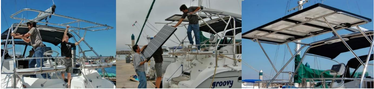
Figura 10 – Estrutura suporte dos painéis fotovoltaicos. Fonte: Cruising World, 2017.
