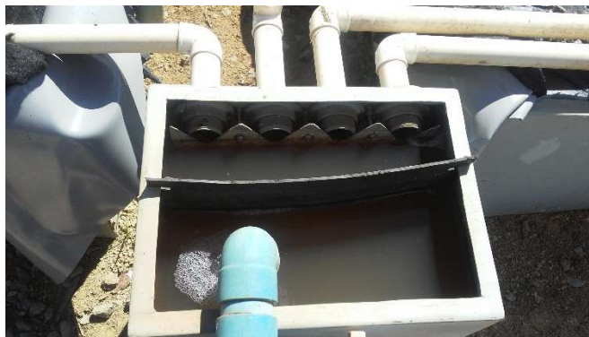
FIGURA 3. Caixa de passagem para os leitos cultivados e vertedouros triangular no interior da caixa de passagem.
