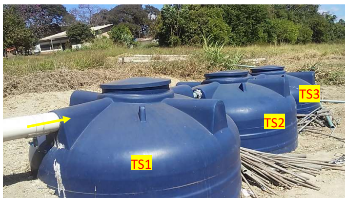
FIGURA 2. Vista dos três tanques sépticos (TS1, TS2 e TS3) e indicação do sentido de escoamento do esgoto.
