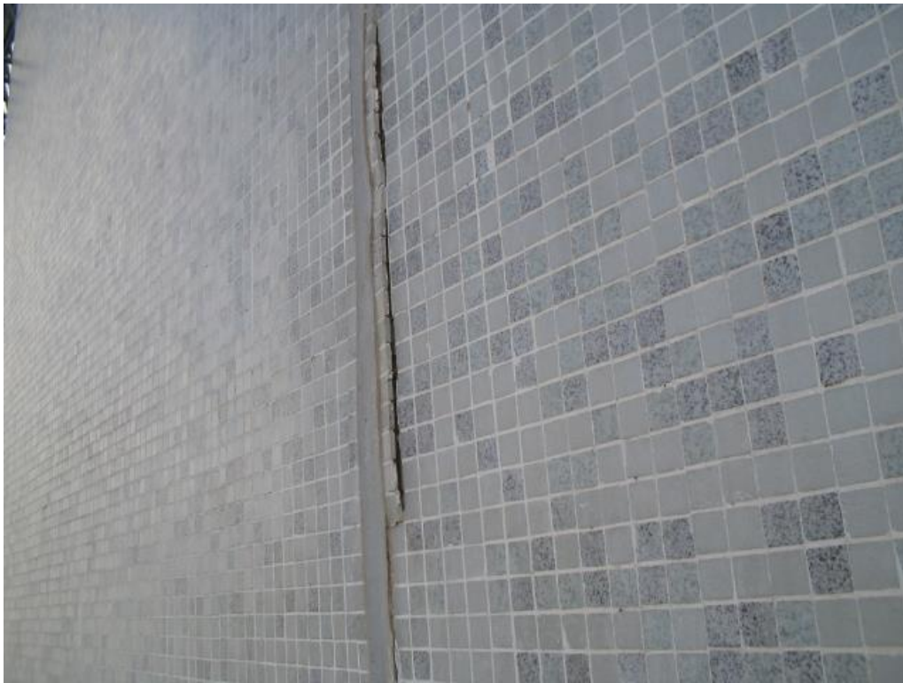
Figura 2.6: Falha na junta (LEM-UnB, arquivo fotográfico).
