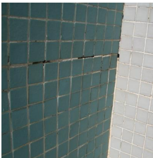
Figura 2.7: Falha de rejunte (LEM-UNB, arquivo fotográfico).
