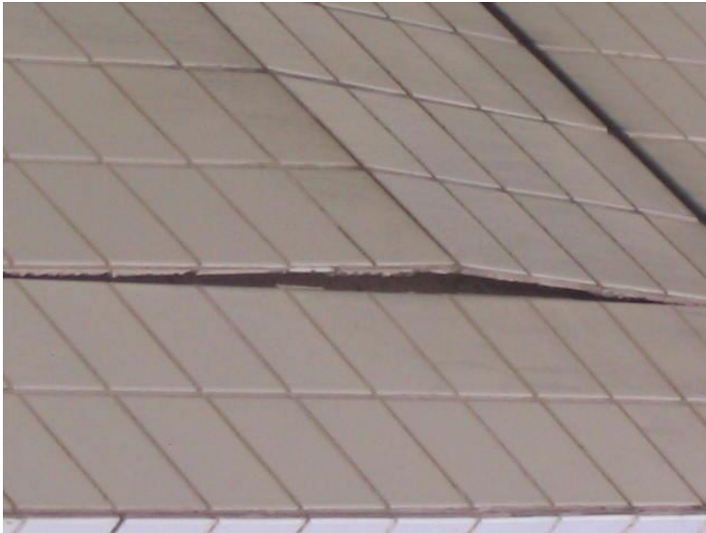
Figura 2.4: Descolamento de placas cerâmicas em prédio da Asa Norte
