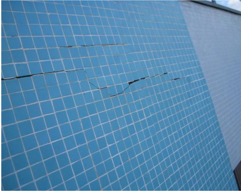
Figura 2.3: Fissura em revestimento cerâmico em prédio na Asa Sul
