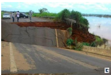
Figura 15 - Ponte Porto Camargo colapsada. Fonte: www.g1.com
