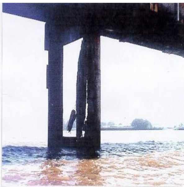
Figura 3 - Acidente no pilar da ponte da SP-225. Fonte: DH-SP (2013)
