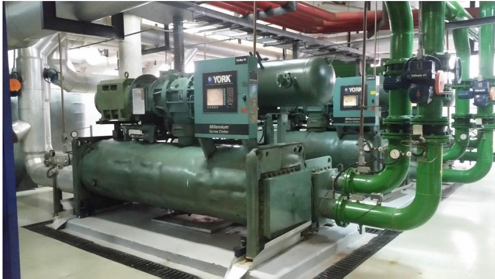
Figura 6. 4 – Chillers da PGR
