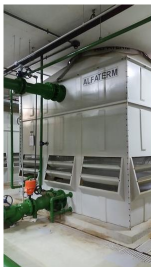
Figura 6. 5 – Torre de resfriamento
