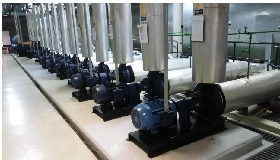
Figura 6. 9 - Bombas primárias e secundárias
