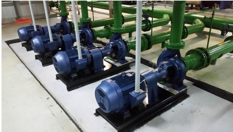
Figura 6. 7 - Bombas de água condensada
