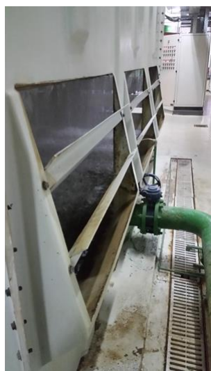
Figura 6. 6 – Detalhe de corrosão na torre
