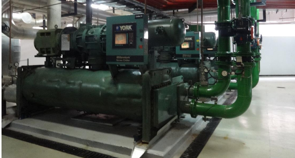
Figura 6. 2 – Chiller parafuso York
