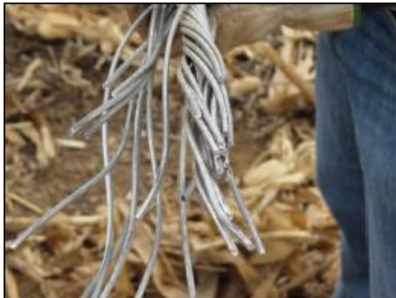
Figura 1 - Imagem de cabo condutor rompido (WATANABE, 2014)
