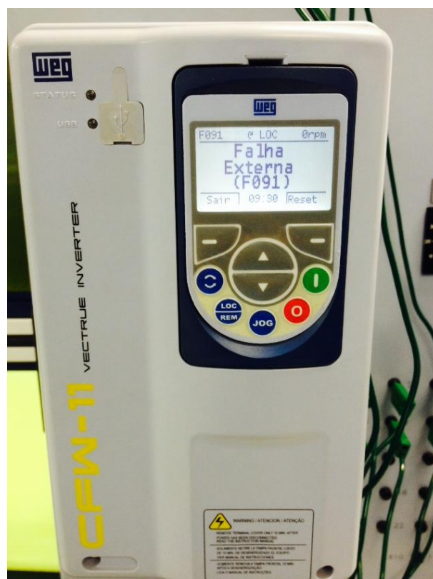
Figura 8. Inversor de frequência
