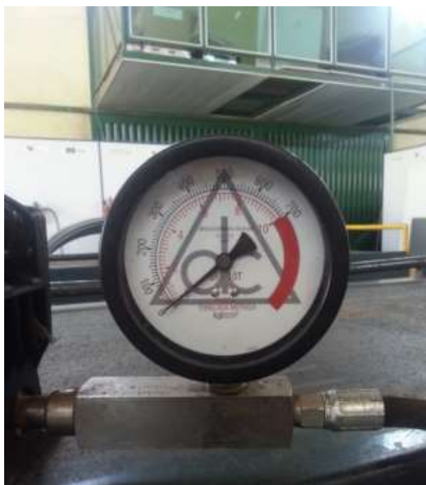
Figura 35 – Detalhe do manômetro acoplado à bomba.
