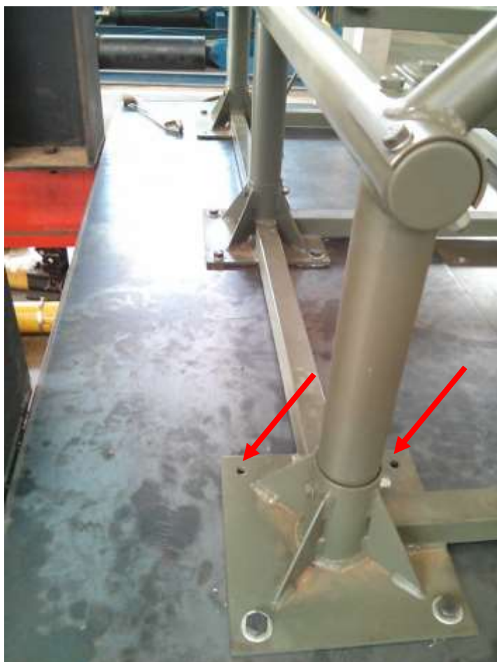
Figura 37 – Detalhe dos furos que não receberam parafusos.
