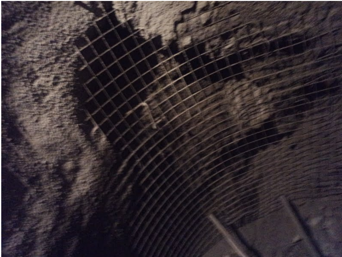
Figura 38 – Detalhe do deslocamento encontrado (Barbosa, 2012)
