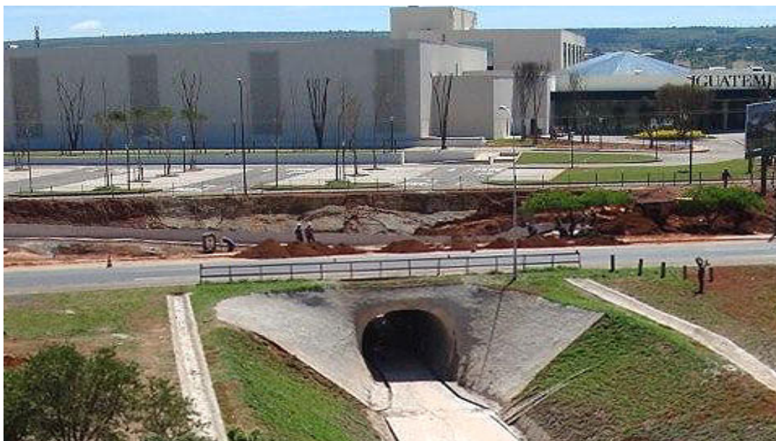
Figura 26 – Concreto projetado para estabilização de talude do emboque e para revestimento de paredes de túnel de passagem do Shopping Iguatemi, em Brasília (Solotrat, 2015)
