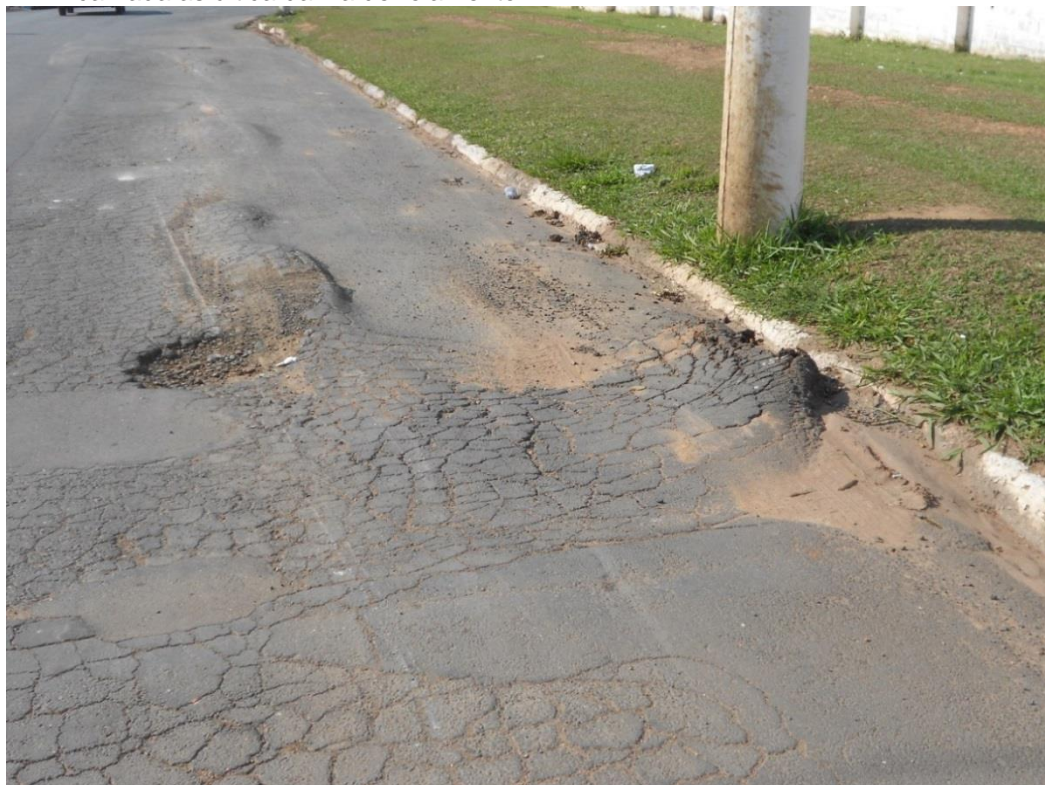
Figura 21 – Rua de acesso à indústria de cerâmica vermelha. Bairro Tomaz Guedes. Danos na camada asfáltica da via de rolamento.
