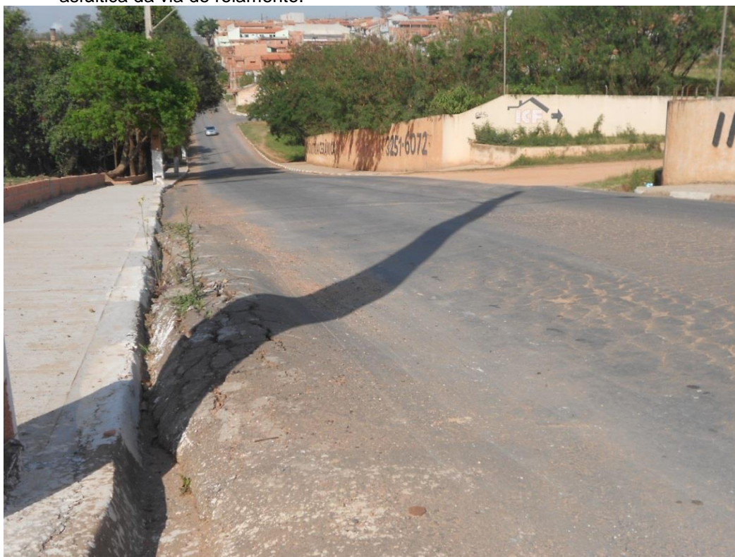
Figura 22 – Rua de acesso à indústria de cerâmica vermelha. Bairro Vale da Lua. Danos na camada asfáltica da via de rolamento.
