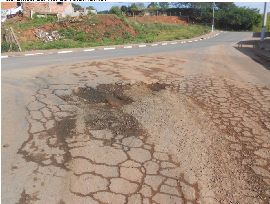
Figura 20 – Rua de acesso à indústria de cerâmica vermelha. Bairro Santa Luzia. Danos na camada asfáltica da via de rolamento.
