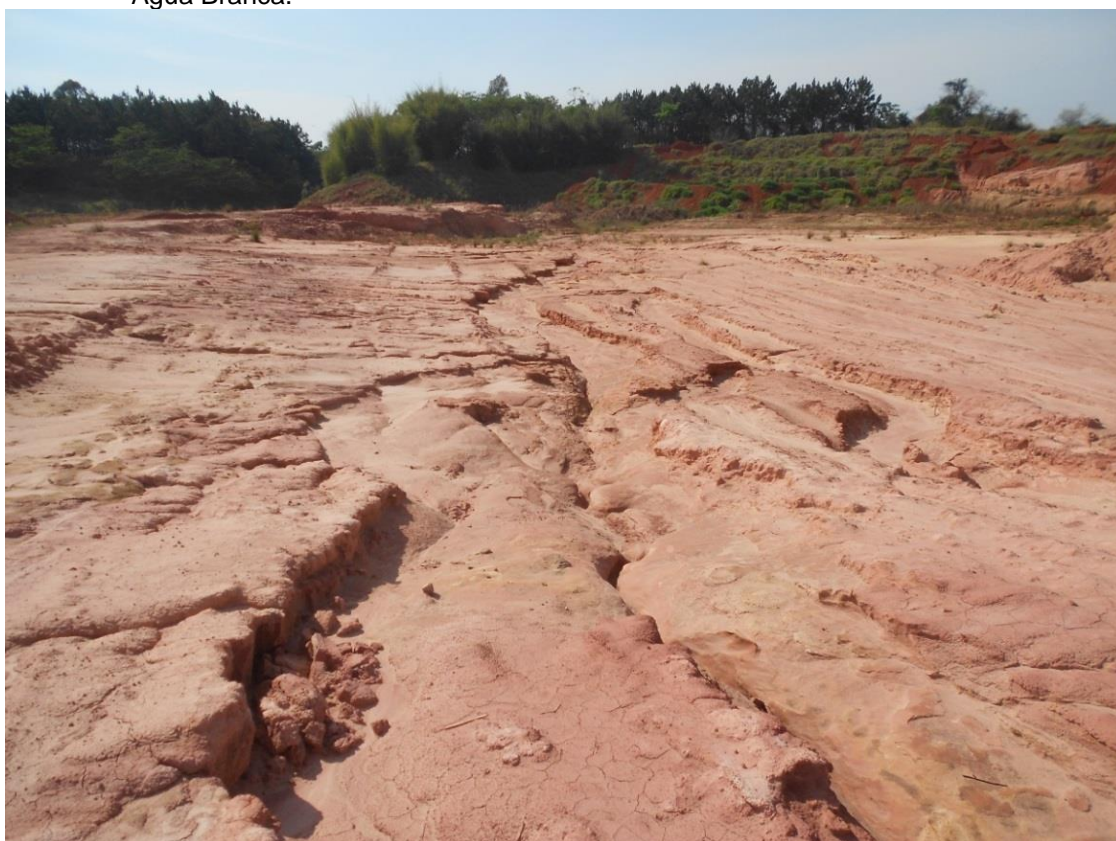
Figura 10 – Barreiro abandonado. Processos erosivos pela ausência de vegetação rasteira. Bairro Água Branca.
